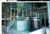
廃液処理施設
